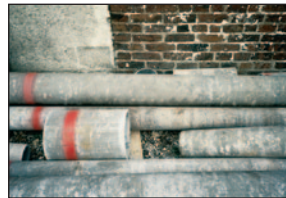
© INRS Canalisation en amiante
