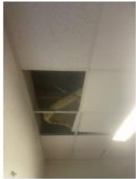
Plafond - plafond endommagé
